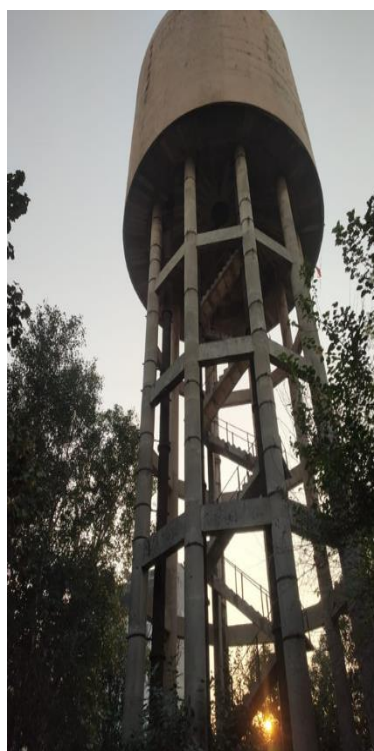
b) Water tank- 2.
